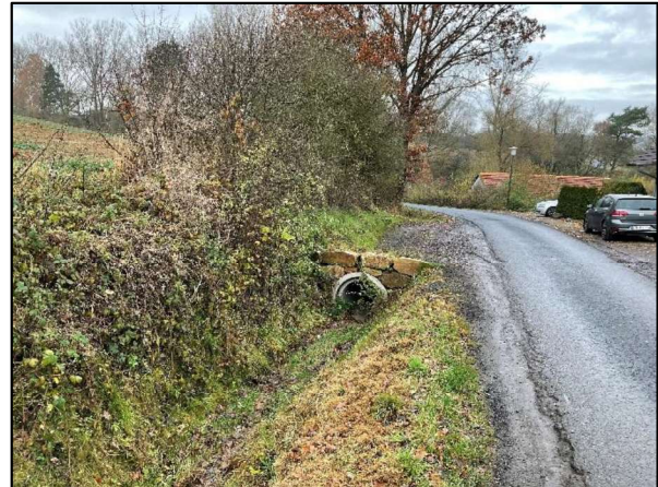
Abb. 6: Ein Teilabschnitt des nördlich verlaufenden Grabens ist verrohrt und mit einer Schotterfläche versehen.
